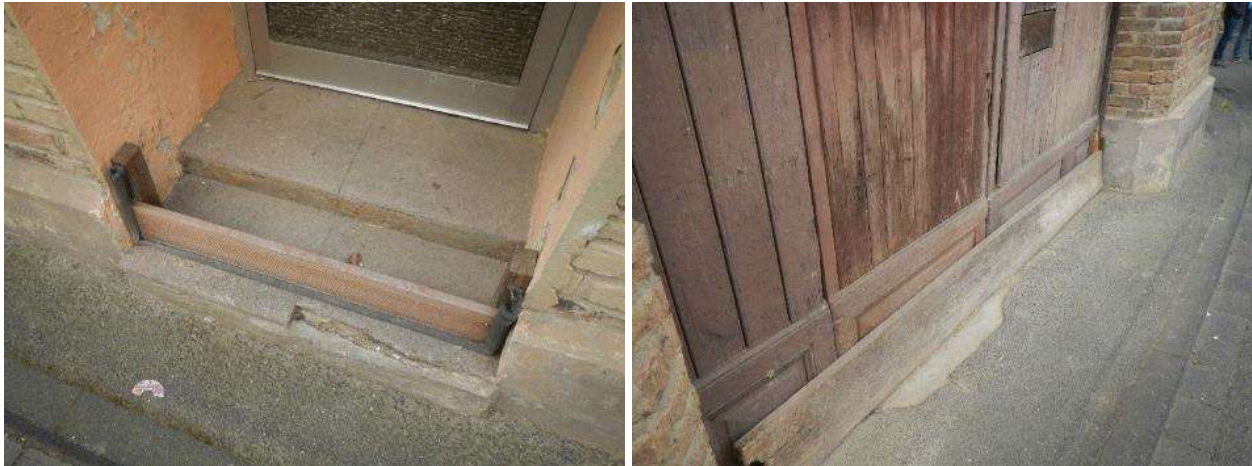
Abb. 5-35: Objektschutz Oberdorfstraße (MX)
