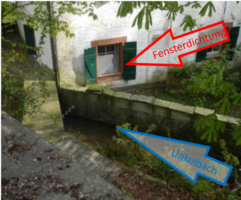
Abb. 5-41: Objektschutz Unkelbrücker Mühle (MX)
